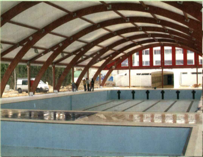
Piscina climatizada en el Polideportivo
