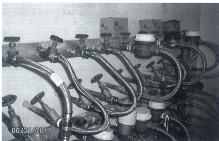
Batería de contadores con latiguillo
